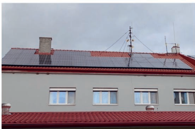
Nová fotovoltaická elektrárna na budově OÚ
