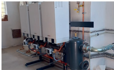
Nová kotelna 2. stupně základní školy
